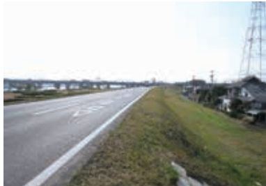
越水による裏側のり面浸食への対策が望まれる天竜川堤防
