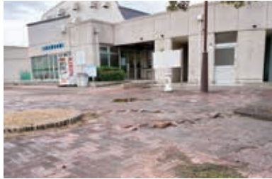
舗装用ブロックが浮き上がっている可美公園水泳場入り口付近
