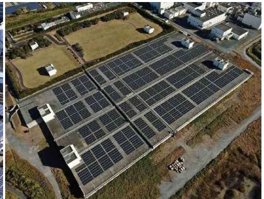
▲ 西遠浄化センターの太陽光発電施設
