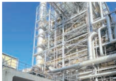
東三河バイオマス発電所(豊橋市)
