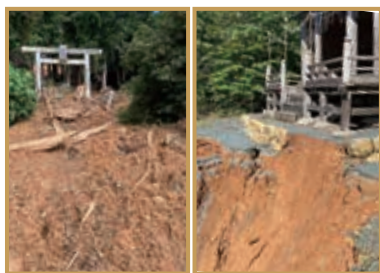
台風第15号で法面が崩壊した高根神社(浜北区尾野)
