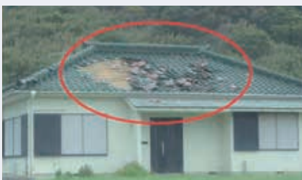
台風による瓦屋根被害の例
