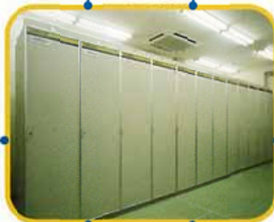
コンピュータ室
