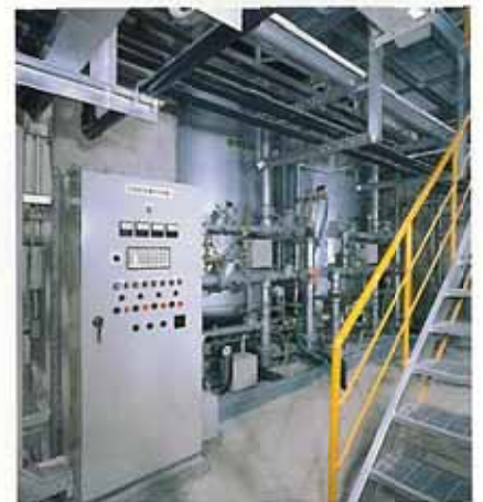
● 活性炭吸着塔
