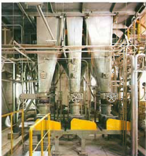
● 消石灰切出し口
