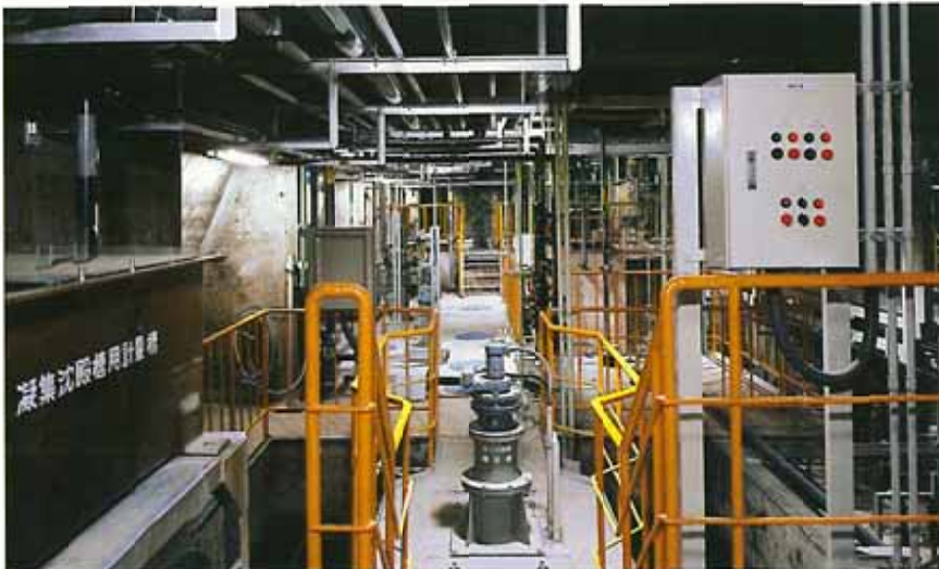
● 排水処理設備
