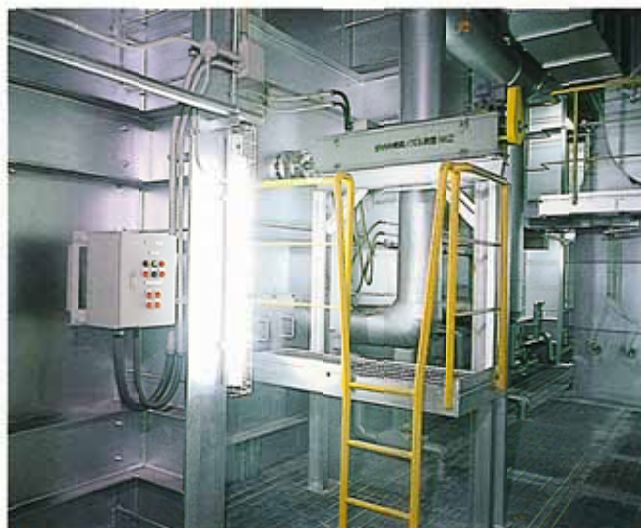
● ごみ汚水噴霧装置
