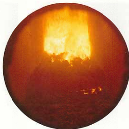
● 炉内燃焼状態
