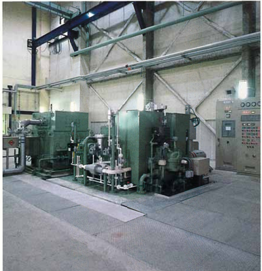
● 蒸気タービン発電機
