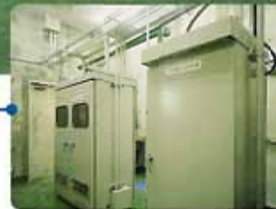
排ガス濃度計測器
