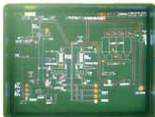
CRT (排ガス処理)
