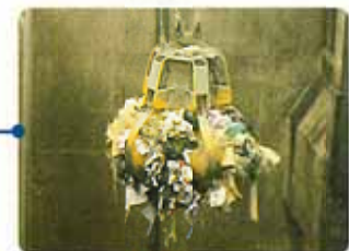
ごみクレーン自動運転制御
