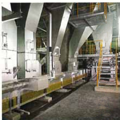
● 落下灰コンベヤ
