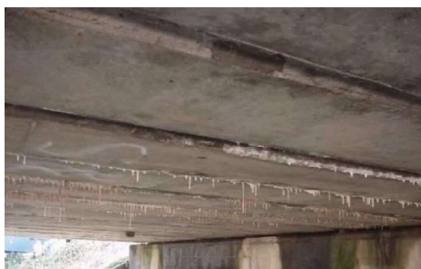
写真 23 遊離石灰（間詰め部）
