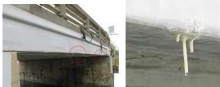
写真 2 6 補強材からの漏水の例
