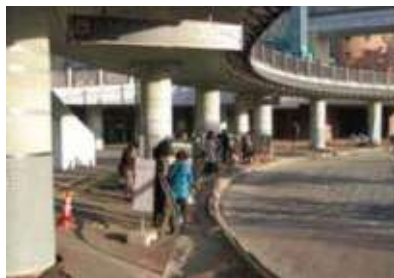
浦安市における地盤沈下の被害例
