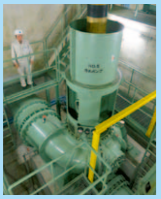
①汚水ポンプ
