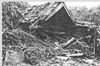
堀谷地内のがけ崩れによる被害の様子
