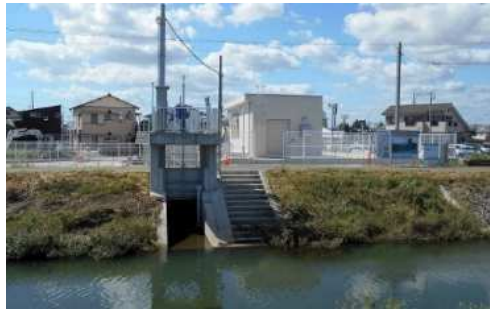
新たに整備した天王雨水ポンプ場 (2022 年度 供用開始)
