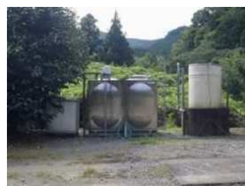
小規模水道施設 〔個人宅〕
