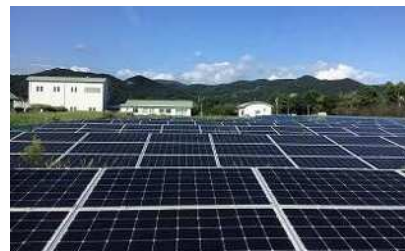
既存の太陽光発電設備 〔三ヶ日浄化センター〕 (今後、他の上下水道施設への導入を検討)
