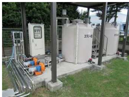
かび臭物質等を除去するための粉末活性炭注入設備 （2020年度導入）〔取水施設（三方原用水第6分水口）〕
