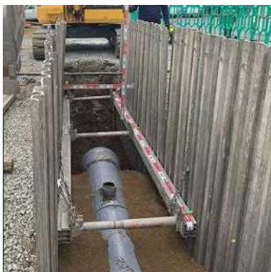
下水道の整備
