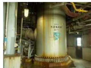
汚泥焼却炉 [中部浄化センター]
