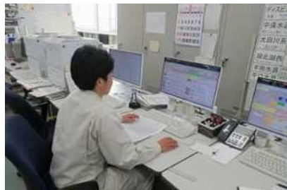
中央監視装置による 水処理工程の常時監視 〔大原浄水場〕
