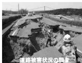
道路被害状況の調査
