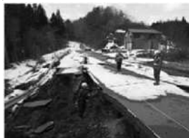
道路施設の被災状況調査
