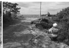
道路施設の被災状況調査
