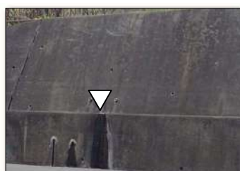
地下水の流出
