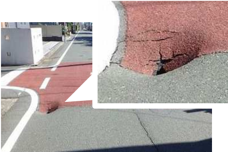
下水道管路の老朽化に起因する道路陥没
