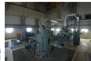
改築予定の雨水ポンプ設備 [参野雨水ポンプ場]
