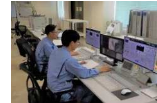
民間事業者による運転管理 〔中部浄化センター：中央監視室〕
