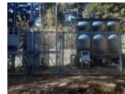
中山間地域の飲料水供給施設
