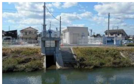
新に整備した天王雨水ポンプ場 (令和4年度 運用開始)
