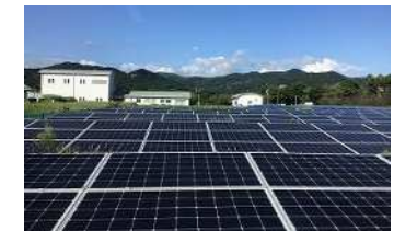
既存の太陽光発電設備〔三ヶ日浄化センター〕 （今後、他の上下水道施設への導入を検討予定）
