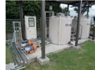
かび臭物質等を除去するために導入した 粉末活性炭注入設備 (令和2年度)〈浄水機能の強化〉 [取水施設 (三方原用水第6分水口)]
