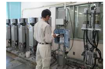
水処理工程における水質監視用計器の点検 [大原浄水場]
