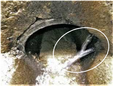
下水道管路の老朽化による侵入水
