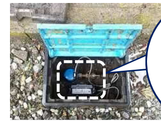
水道スマートメーター設置<実証実験> (令和5～6年度)
