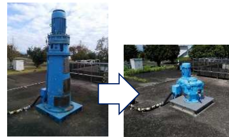
小型でエネルギー効率の高い急速攪拌機への更新 （令和2年度）〔大原浄水場〕
