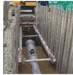
下水道の整備
