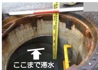
地震の影響で破損した下水道管路に起因する マンホール内の滞水 [石川県珠洲市]
