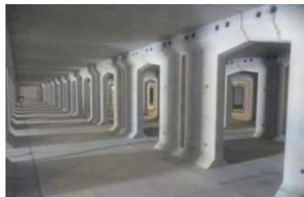
公園地下に整備した雨水貯留施設[可美地区] (令和元年度 運用開始) ※写真は建設当時
