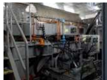
脱水機 [中部浄化センター]
