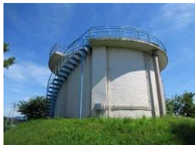
大原浄水場の運用開始当時から稼働している養水井
