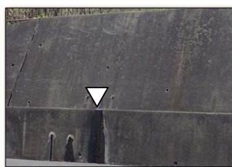
地下水の流出
