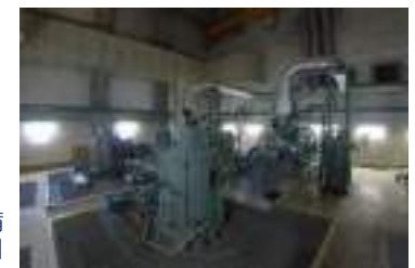
改築予定の雨水ポンプ設備 [参野雨水ポンプ場]
