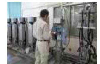
水処理工程における水質監視用計器の点検 [大原浄水場]
