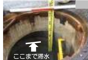
地震の影響で破損した下水道管路に起因する マンホール内の滞水 [石川県珠洲市]
