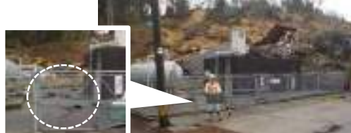
地震の影響で破損したポンプ場 ＜水道施設＞ [石川県珠洲市]
