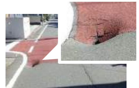
下水道管路の老朽化に起因する道路陥没
