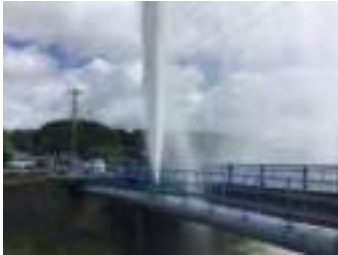
水管橋の空気弁の老朽化に起因する漏水 (令和5年度) [中央区伊左地町]
