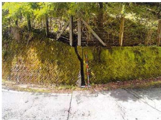
県道水窪森線（春野） 擁壁ひび割れ
