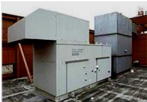
非常用自家発電設備
