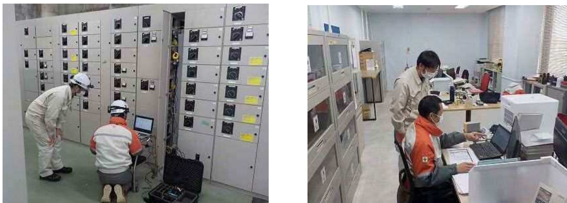
図 14 電流信号診断および PC による劣化状況の確認
