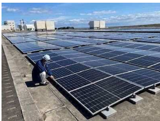
図9 ソーラーパネル設置状況確認（水処理棟）
