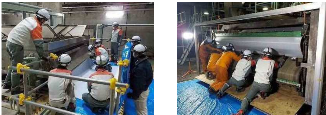
図 13 内製化によるベルト濃縮機及びベルトプレス脱水機ろ布取替状況確認
