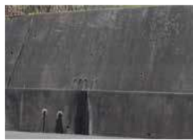
<地下水の流出>
