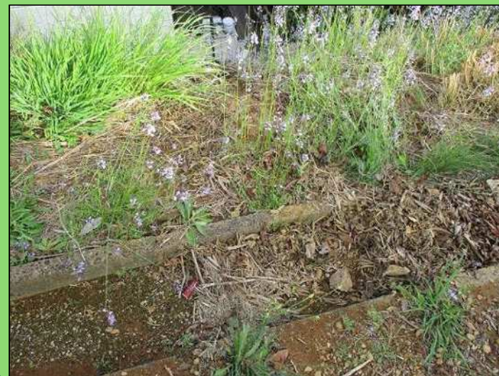
排水路の閉塞
