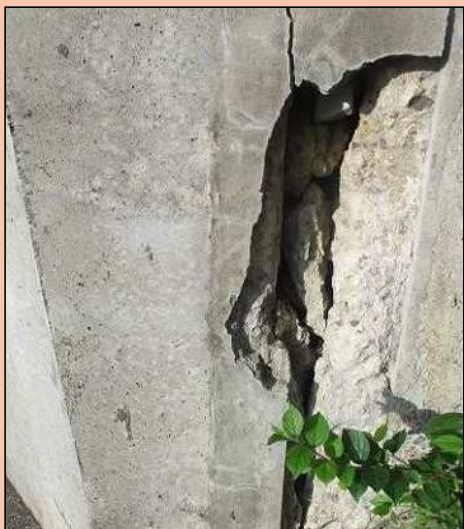
擁壁のひび割
