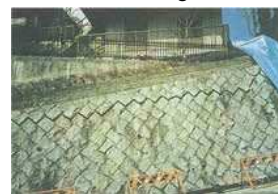
< Vết nứt trên tường chắn đất >
