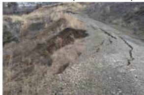
< Vết nứt trên phần đất đắp >
