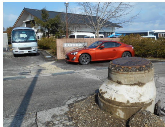
珠洲市マンホールの突出と地面の亀裂・陥没
