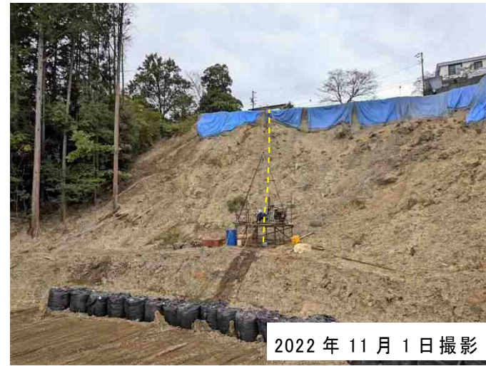
写真-4.3.5 副測線 B-M 付近の斜面状況
