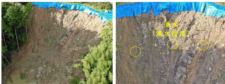
写真-4.3.2 2022年9月25日(崩落翌日)の斜面状況
