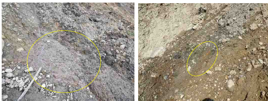
写真-4.3.3 2022年9月27日の湧水状況 (中央部)
