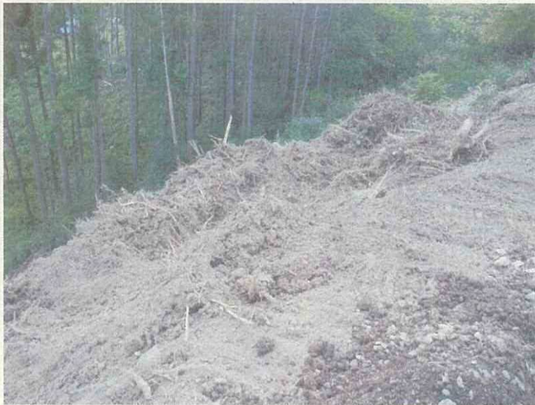
南側法面木の根投棄状況
