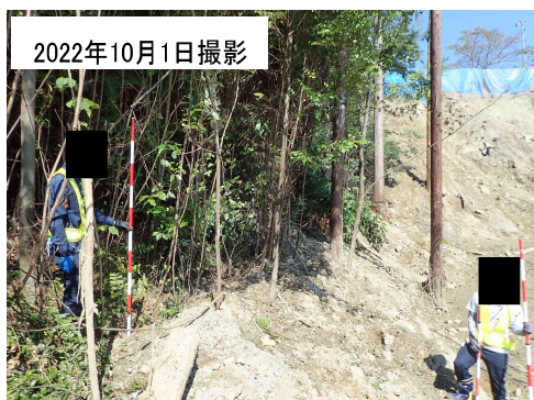
写真-7.1.5 盛り土部周縁斜面の状況
