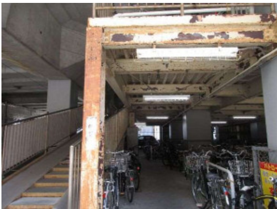
図 42- 駐車場施設の塗装の劣化状況
