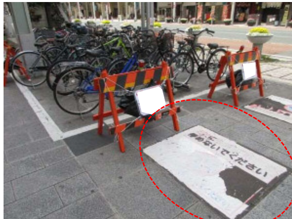
図 43- 駐車場の注意喚起標識の劣化状況
