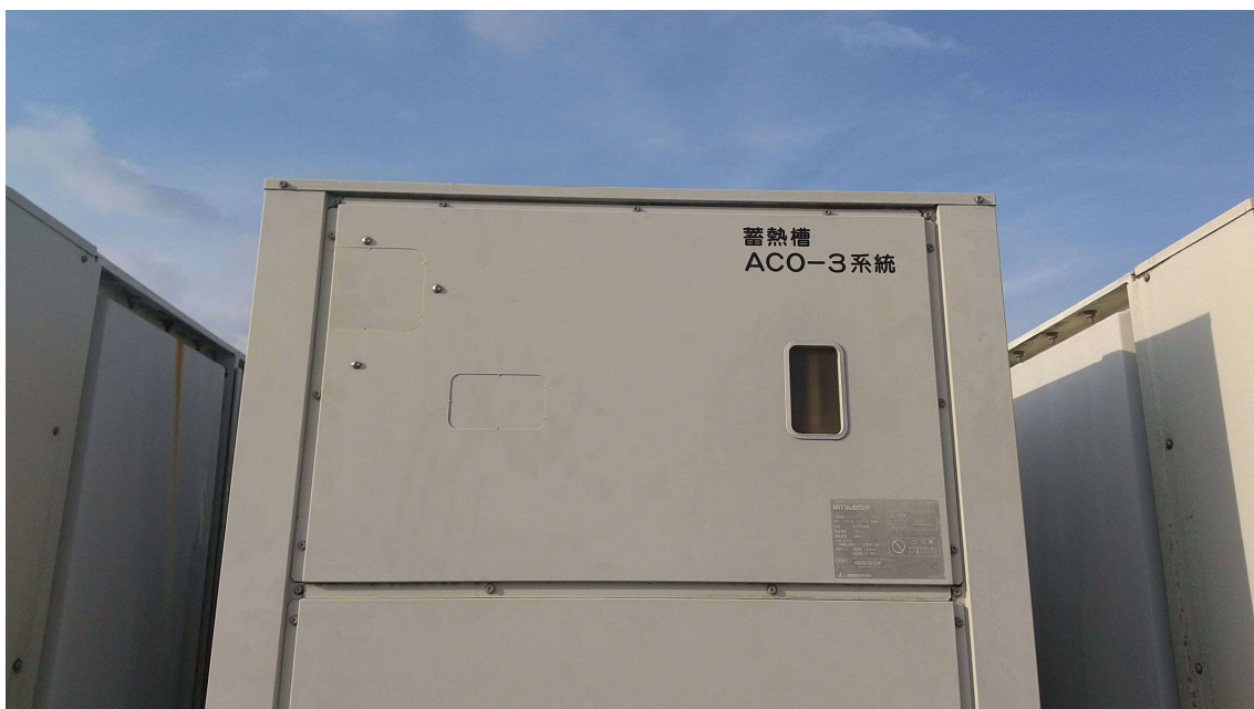
工事対象の蓄熱槽（ACO-3系統）
