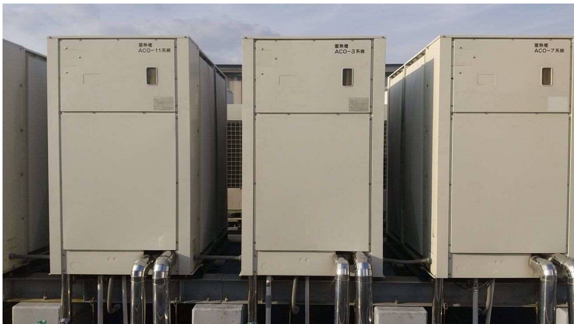
区役所屋上の蓄熱槽
