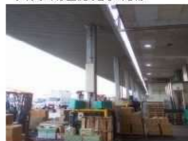
買荷保管積込所と卸売場庇との間の隙間
