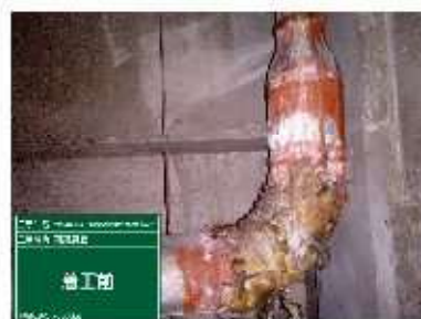
老朽化した設備系統
