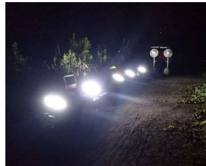
照明機器の設置状況
