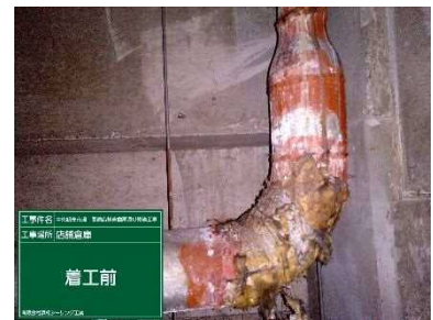
老朽化した設備系統
