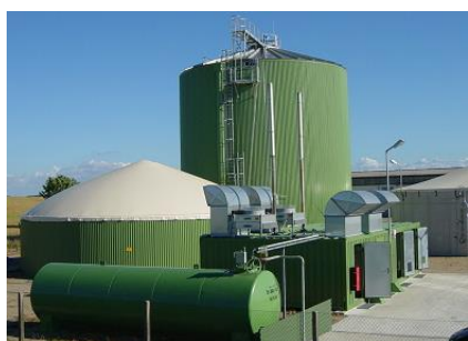
メタン発酵方式によるバイオガス発電施設 (農林水産省ホームページ)
