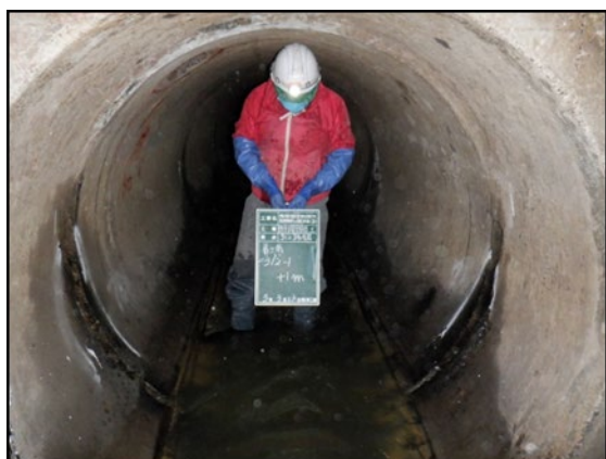
&lt;改築前&gt;老朽化した管路
