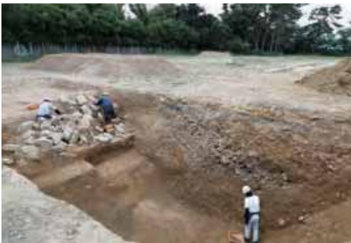
本丸東側の堀と崩落石垣
