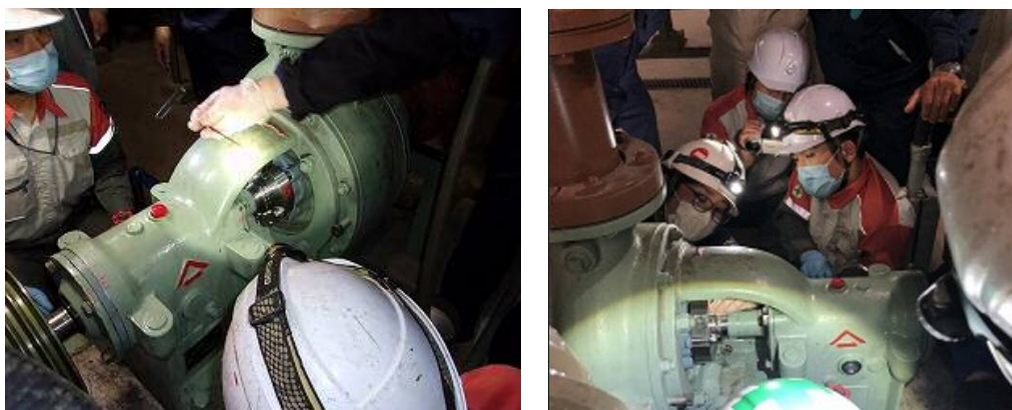
図 12 技術力向上のための汚水ポンプメカニカルシール取替状況
