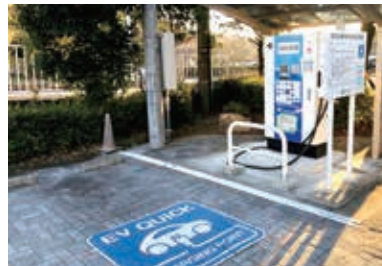
花川運動公園の急速充電設備
