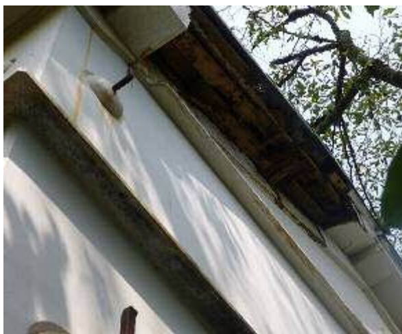
写真3 軒下漆喰崩落状況
