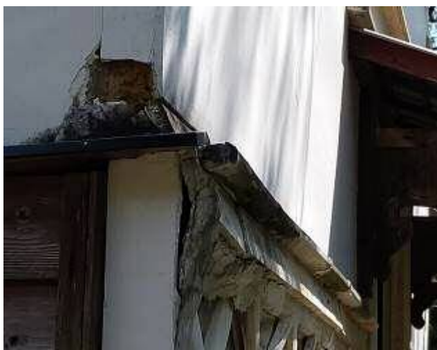
写真7 外壁の破損状況
