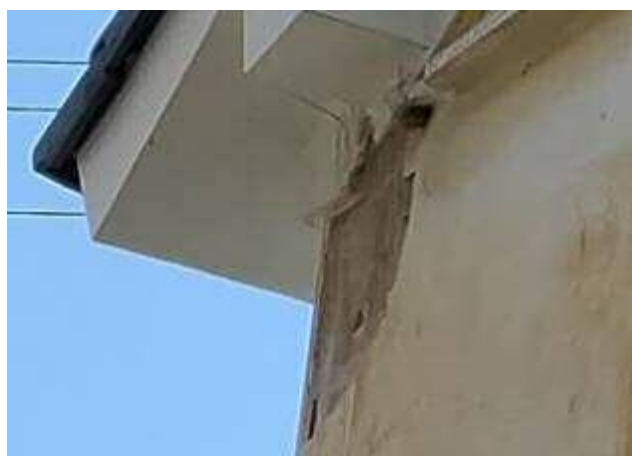
写真6 外壁の漆喰崩落状況
