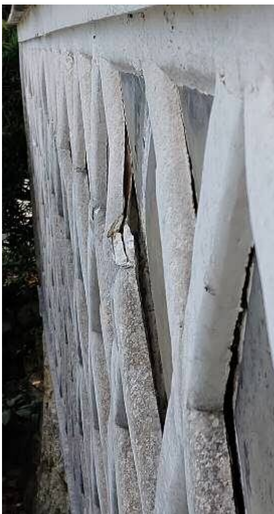
写真5 なまこ壁の剥落状況
